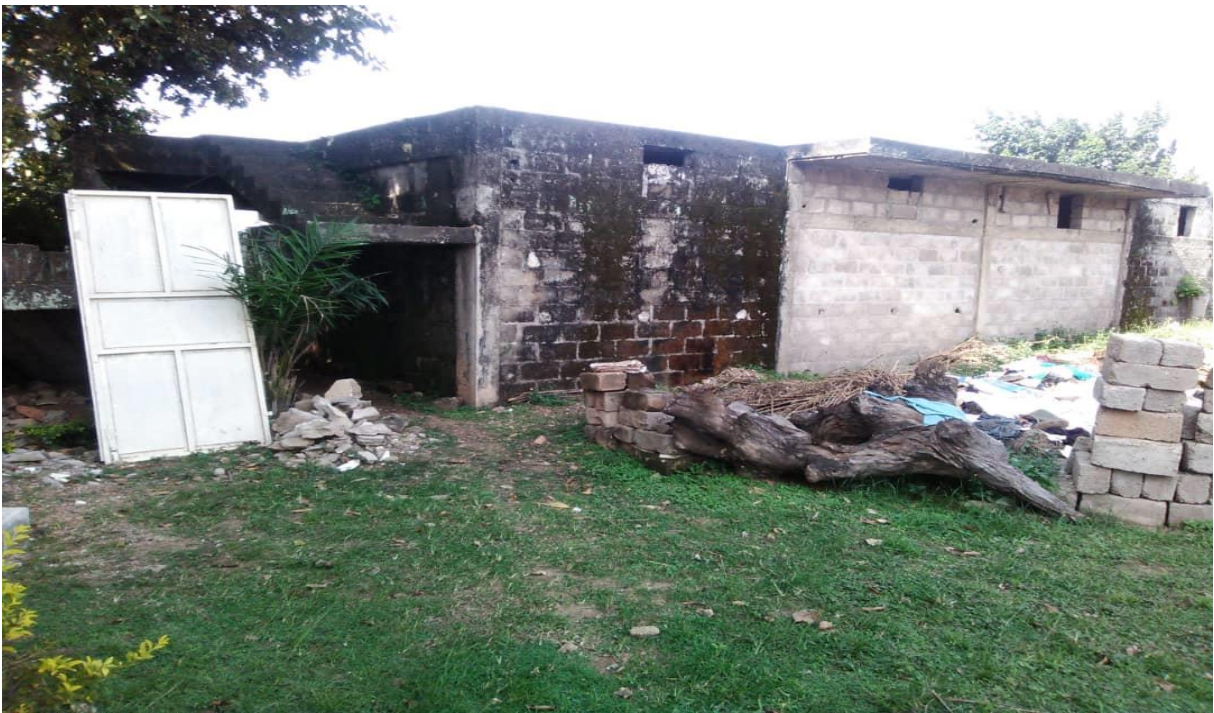
Bâtiments inachevés depuis 2010. Le contrat parle d'un immeuble à trois niveaux comprenant des boutiques et des magasins.
